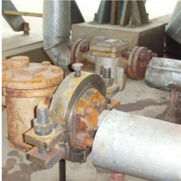
图四：现场管线法兰连接部位
